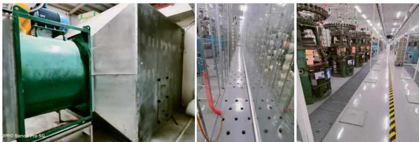
Hình 3-11 Hệ thống hút bụi phân xưởng dệt Lô số M.25a-27b
