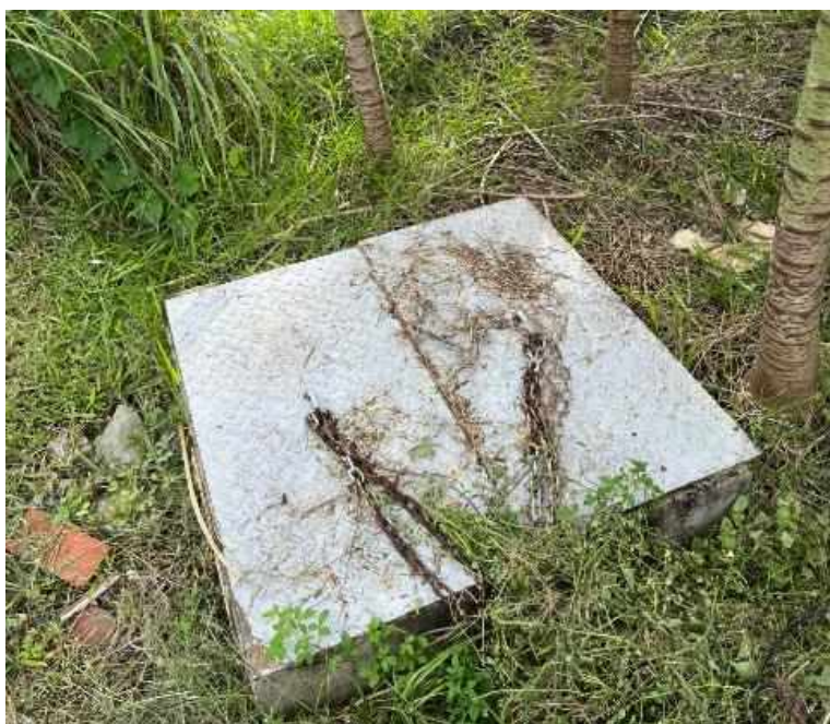
Hình 3-3 Hố ga đầu nổi nước thải của nhà máy trên đường số 10
