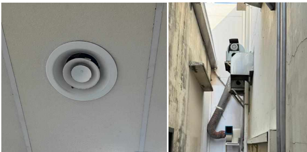
Hình 3-14 Phễu hút mái và quạt hút của hệ thống thông gió nhà xưởng
