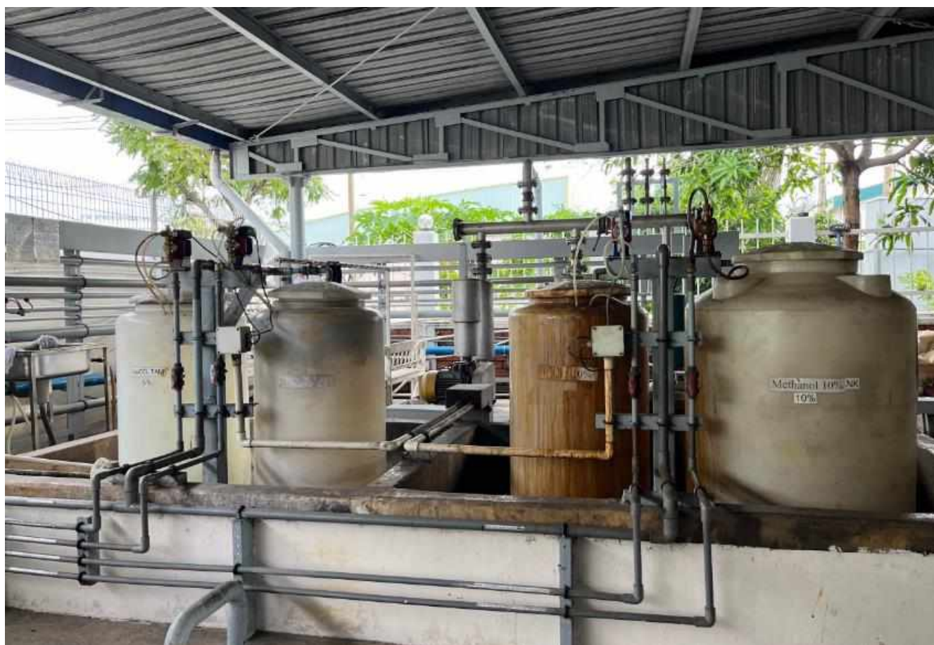
Hình 3-7 Hệ thống xử lý nước thải của Nhà máy
