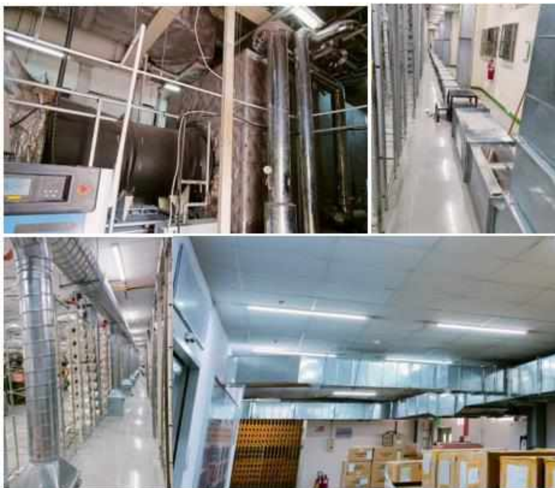
Hình 3-9 Hệ thống hút bụi phân xưởng dệt khu A
